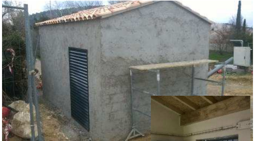
Réalisation du local technique du poste de refoulement au droit du bassin pluvial des Ratacans
